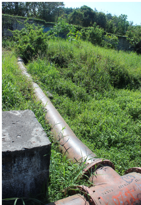
Figure 6. Photo des canalisations qui acheminent l'eau de la source et suivent le tracé de l'ancien canal Casasano (2014). Auteur : Jade Latargère.
