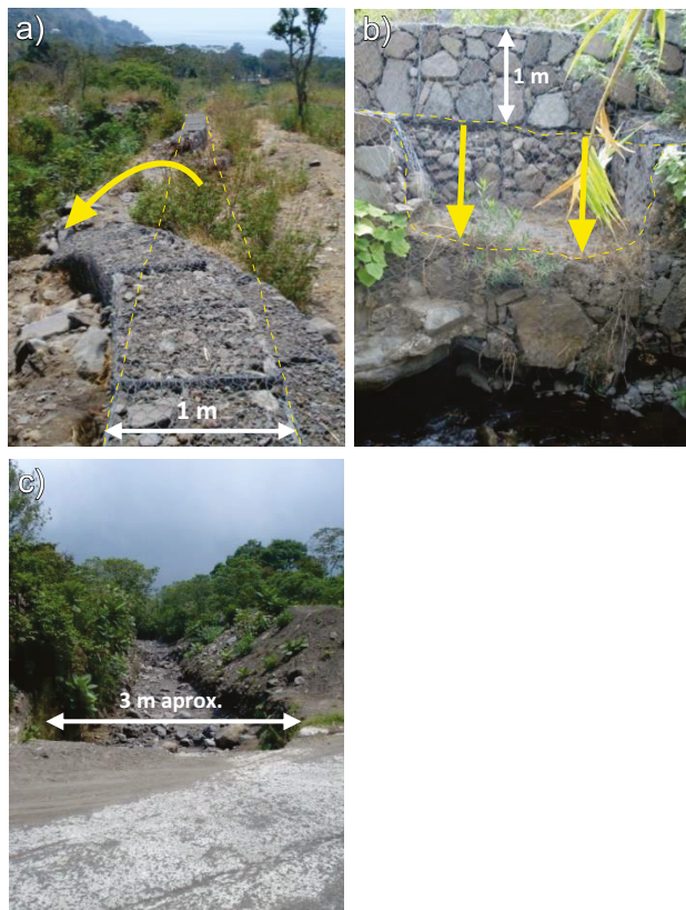
Figura 3. a) Gaviones volcados en el margen derecho de la canalización principal del río. La flecha amarilla indica la dirección del movimiento de los gaviones. b) Muro de gaviones afectado por erosión basal. Las flechas amarillas indican la dirección del movimiento de los gaviones. c) Tramo de canal dragado cercano a la población de Santiago de Atitlán. En la fotografía se observa cómo el material dragado se acumula en los bordes del canal a modo de dique sin realizar sobre él ningún tipo de consolidación.
