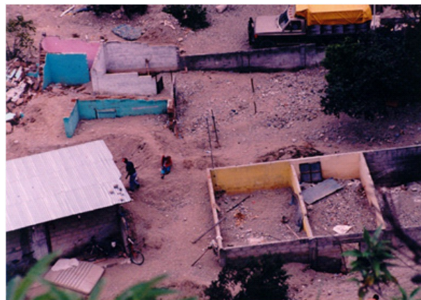
Figura 9. Comportamiento de los flujos de escombros emplazados en la comunidad de Motozintla y los daños provocados por el desastre de 1998.
