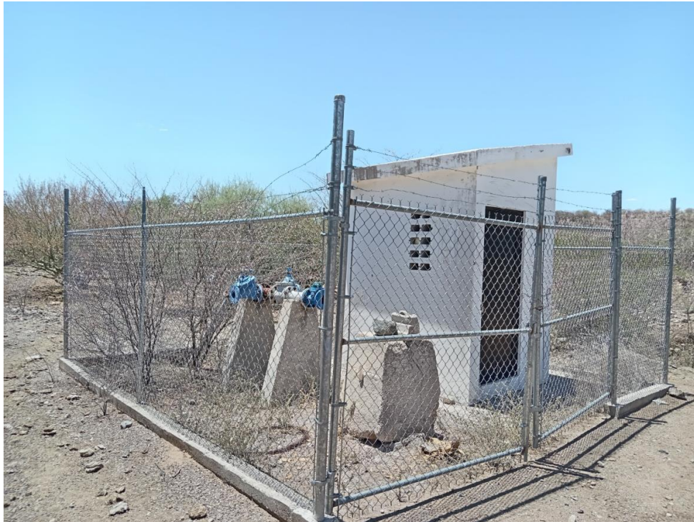
Figura 3. Nuevo pozo del FRS en Aconchi
