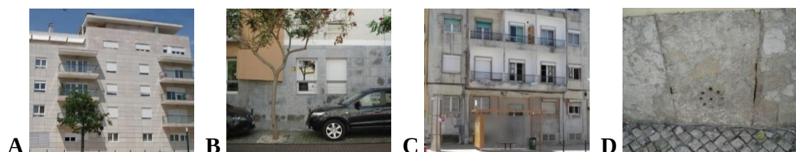
Figura 1. Condiciones de degradación de los revestimientos pétreos
