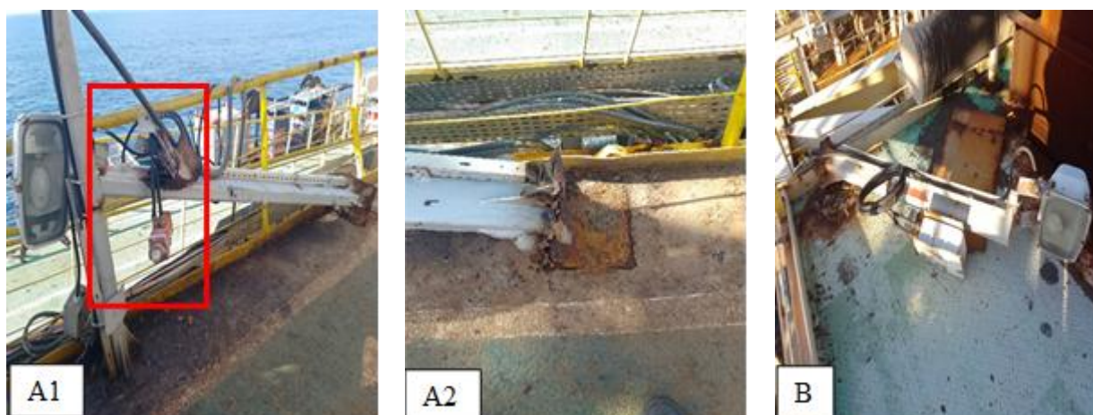
Figura 5. Colapsos por corrosión de la base de postes de iluminación metálicos.
