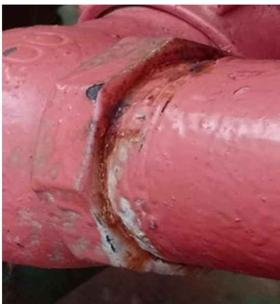
Figura 4. Corrosión en la junta roscada de una línea contra incendios.
