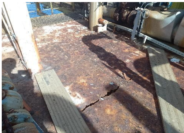
Figura 12. Efectos de la corrosión en suelos y vigas metálicas.
