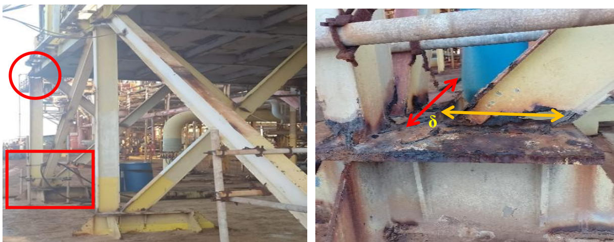
Figura 10. Degradación de las uniones soldadas y alteraciones en los enlaces de las estructuras.
