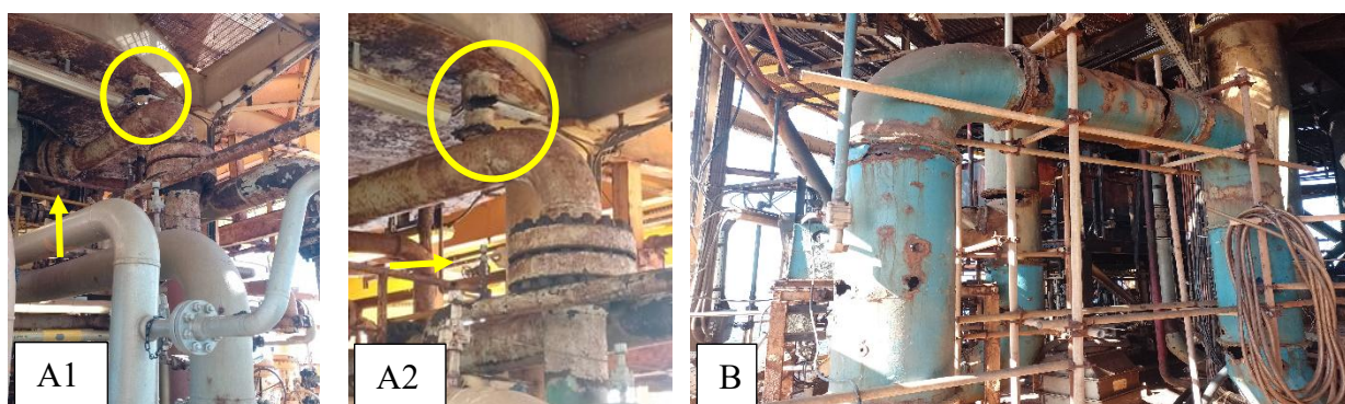
Figura 6. Daños en líneas y accesorios.
