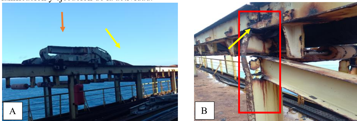
Figura 9. Daño en la columna de la cinta transportadora de una línea de descarga.
