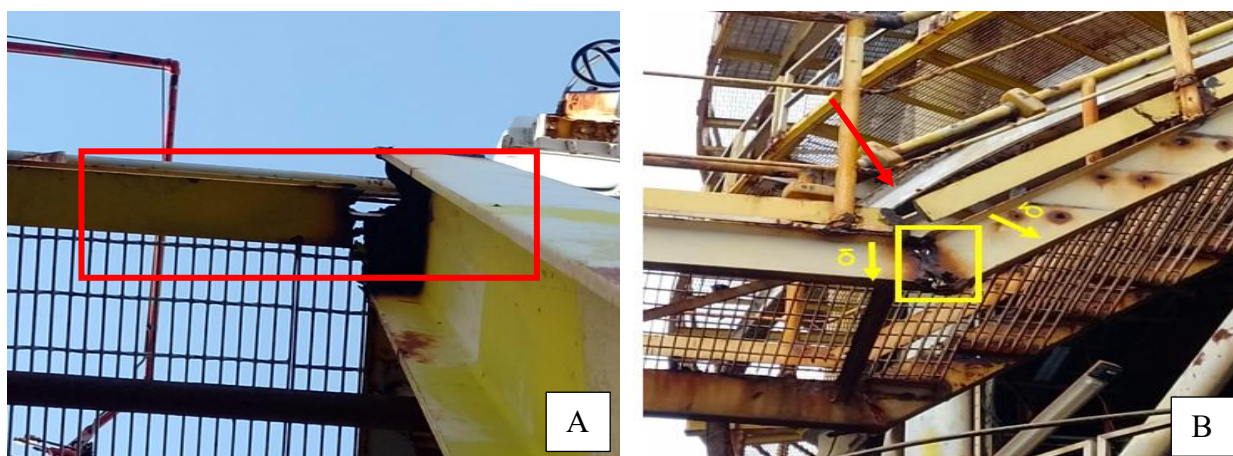
Figura 13. Rotura por corrosión en la intersección viga-columna (A) y viga-viga (B).
