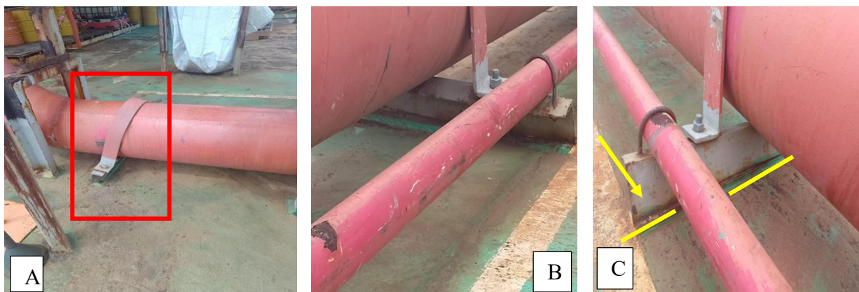
Figura 7. Deformación y grieta en perfil metálico.
