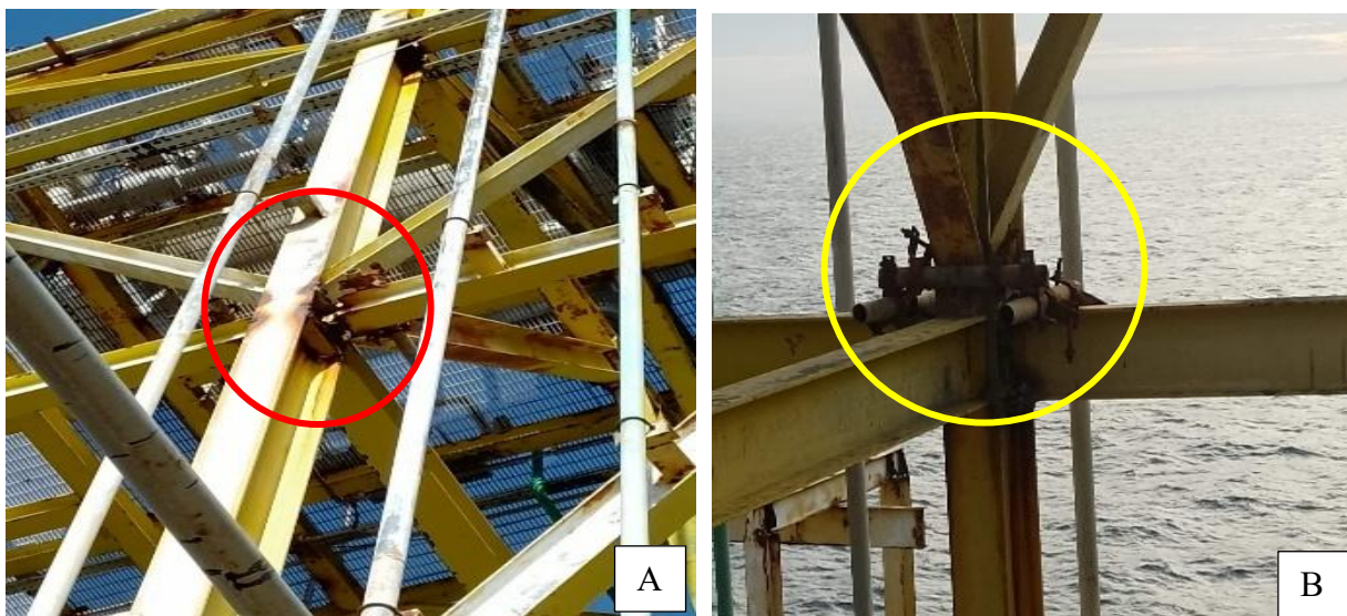
Figura 11. Fallo local en el nodo de la estructura espacial por pérdida excesiva de masa, causada por un proceso corrosivo.
