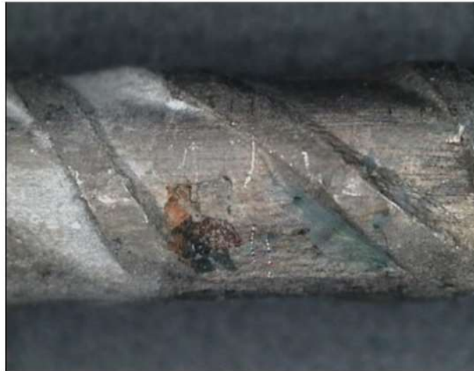
Figura 4. Pequeña zona despasivada debido al ataque por cloruros.
