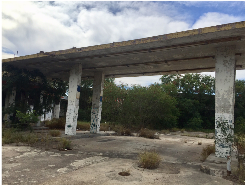
Figura 2. Edificación de tipo comercial abandonada en Nuevo Laredo
