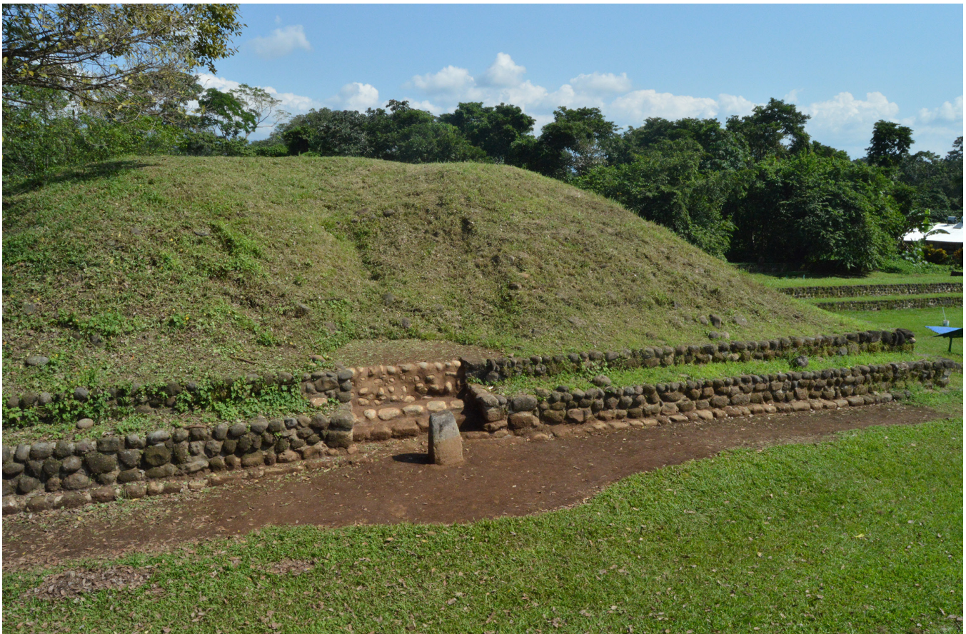
Figura 3 Fachada sur de la Estructura 125-A. Obsérvese la depresión en el área excavada por la NWA (Lowe et al. , 1982) ocasionada por el hundimiento de los materiales de relleno no compactados.
