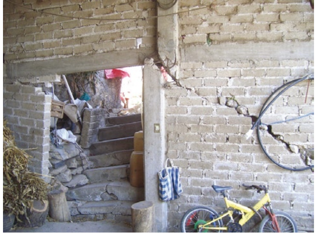
Figura 8. Imagen que muestra los daños producidos en una pared, fracturamiento, el castillo ha sido roto y la varilla de acero de 1" doblada, ancho de la puerta 1.5 m.
