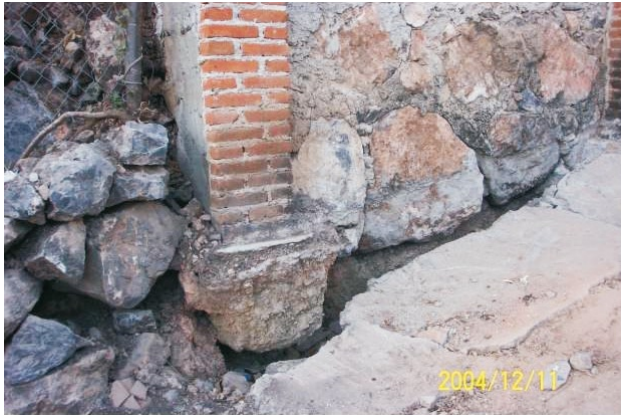
Figura 13. Imagen que muestra como el cemento de la vivienda no está desplantado dentro de la roca sobre la que se construyó.
