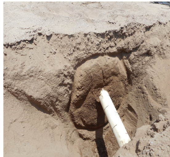
Figura 5. Bulbo húmedo en el sistema RSD.
