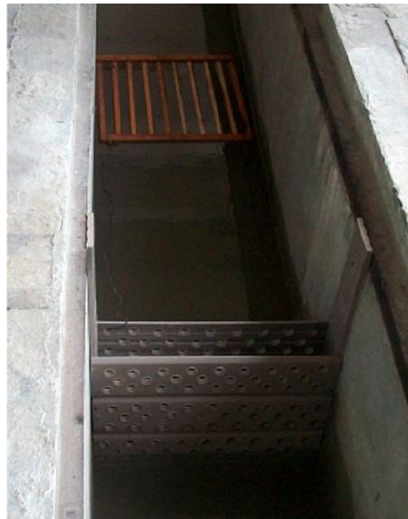
Figura 4. Tranquilizadores de flujo aguas abajo de la descarga del vertedor de aforo.
