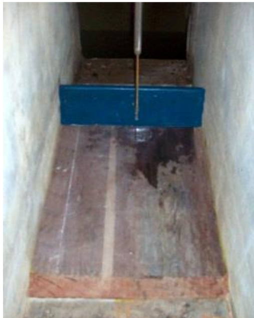
Figura 2. Cimacio elíptico impermeabilizado.
