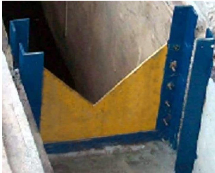
Figura 3. Vertedor de aforo visto desde aguas abajo.
