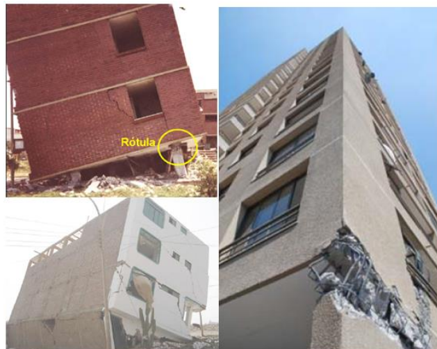
Figura 3. Falla estructural en columnas de planta baja derivado de una configuración de piso suave (Aguilar, 2010)
