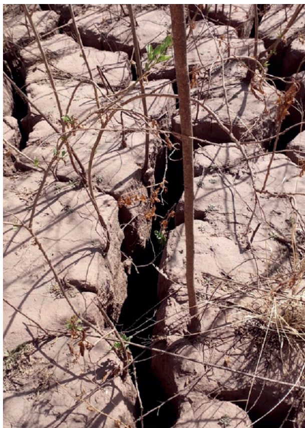
Fig. 15. Grietas presentes en la superficie de la presa de jales Boleo Estrella
