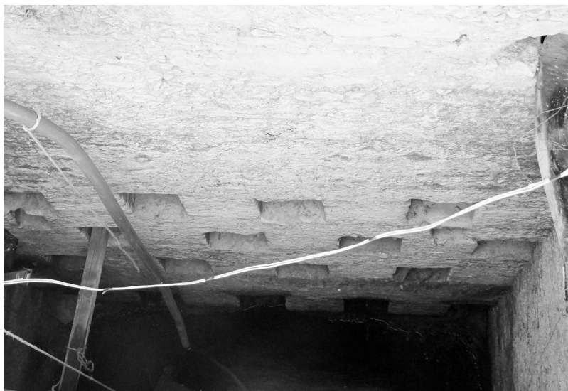
FOTOGRAFÍA 6. ADEME DEL POZO AUXILIAR. EL MURO QUE DA HACIA EL TANQUE CUENTA CON ORIFICIOS PARA FACILITAR EL ESCURRIMIENTO DEL AGUA FILTRADA
