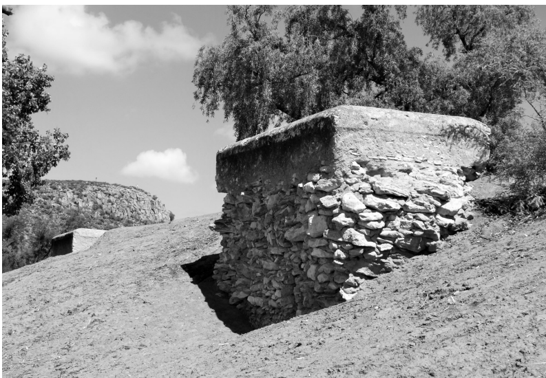
FOTOGRAFÍA 5. RESPIRADEROS O LUMBRERAS EN LA CORTINA DEL TANQUE. EL CUELLO SE HACE MÁS EVIDENTE POR LA EROSIÓN DEL TALUD
