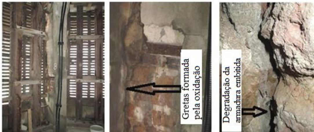
Figuras 4 a 6. Fissuras causadas pela oxidação das braçadeiras de ferro inseridos nas colunas
