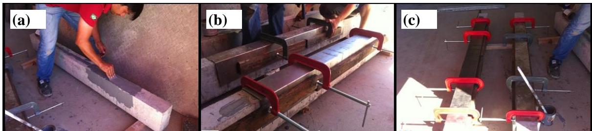
Figura 4. (a) Aplicación del adhesivo epóxico para anclar los perfiles de acero; (b) Colocación de fijadores; (c) Sistema de fijación final de las chapas.
