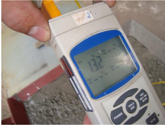
Figura 8. La temperatura del hormigón fresco se controlaba para cada camión hormigonera mediante un termómetro digital de inmersión (ejemplo: 13.2°C).
