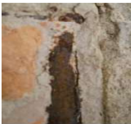
Figura 5. Armadura longitudinal corroída nos pilares.
