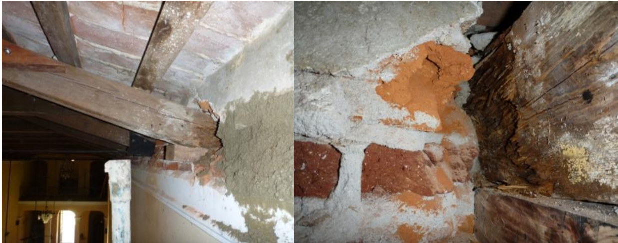
Figura 12. Imágenes de patología del par en los apoyos
