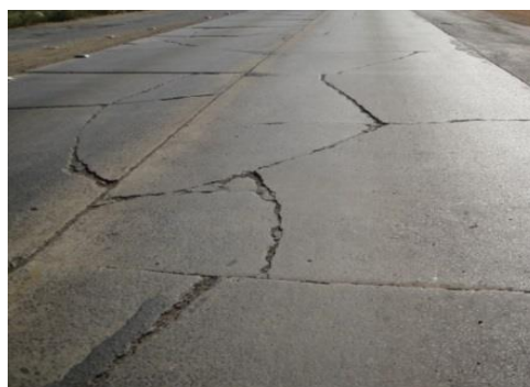
Figura 2. Fissuras lineares observadas nas placas de concreto da rodovia ERS-118, nas proximidades do Km 23.
