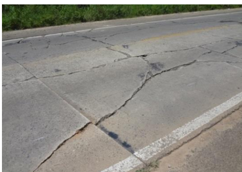
Figura 1. Fissuras lineares observadas nas placas de concreto da rodovia ERS-118, nas proximidades do Km 20.
