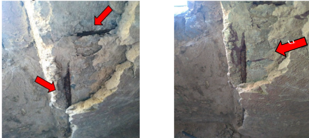
Figura 1. Desprendimiento de hormigón y corrosión de la armadura en el elemento P01
