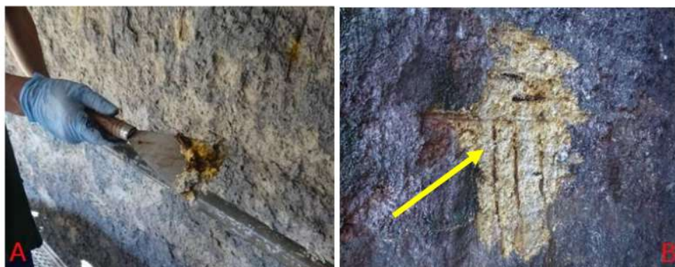
Figura 2. (a) Facilidade de remoção da camada de concreto degradada utilizando uma espátula e (b) trecho de dissolução das armaduras
