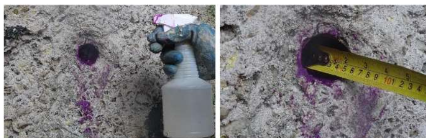
Figura 4. Muro de pozo húmedo con hormigón alcalino.
