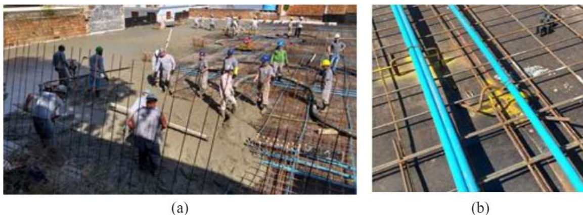
Figura 1. Operação de concretagem: (a) Manuseio da mão de obra em contato com a armadura. (b) Espaçador danificado e mal posicionado.
