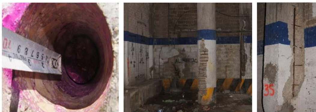
Figura. 3. Carbonatação e desprendimento de concreto
