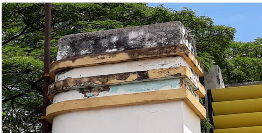
Figura 14. Suciedad y desprendimiento de pintura en la parte superior del pilar
