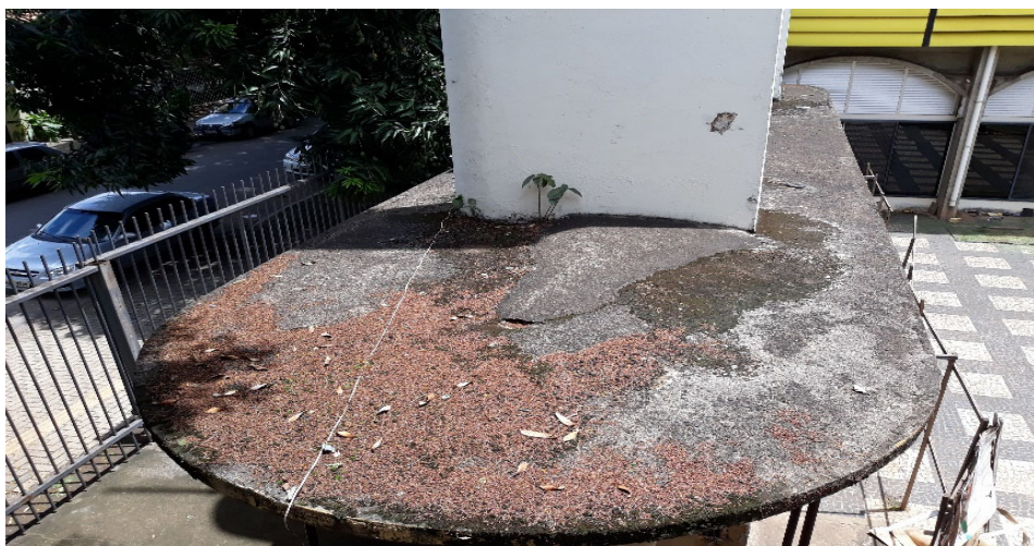
Figura 11. Presencia de moho y suciedad en la losa
