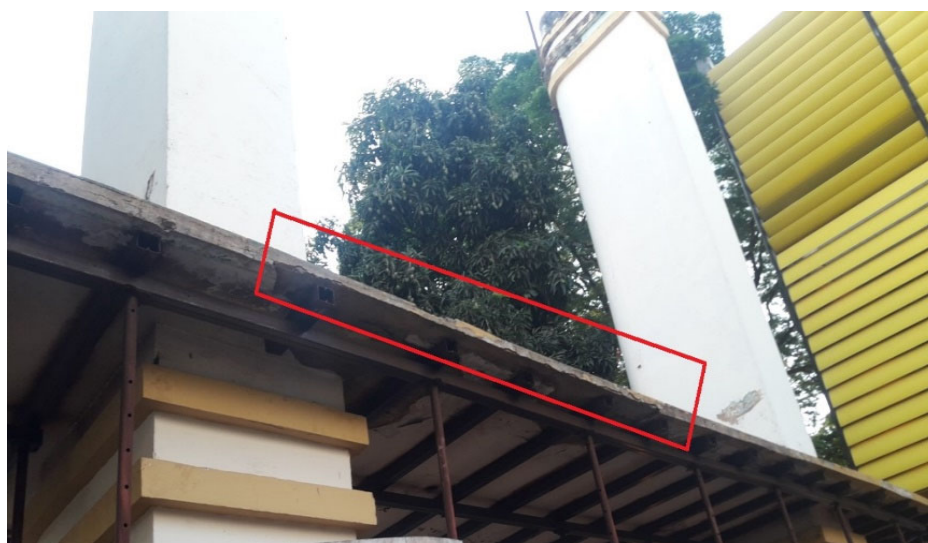
Figura 12. Desprendimiento del borde de la losa
