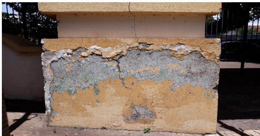
Figura 15. Incidencia de grietas y decoloración de la pintura.
