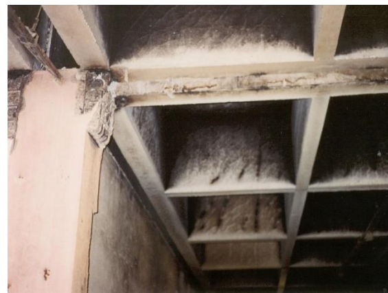
Figura 12. Deslocamento de apoio de estrutura pré-moldada submetida a incêndio
