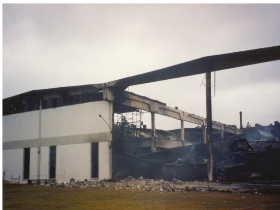
Figura 11. Ruína de edifício com estrutura pré-moldada submetida a incêndio
