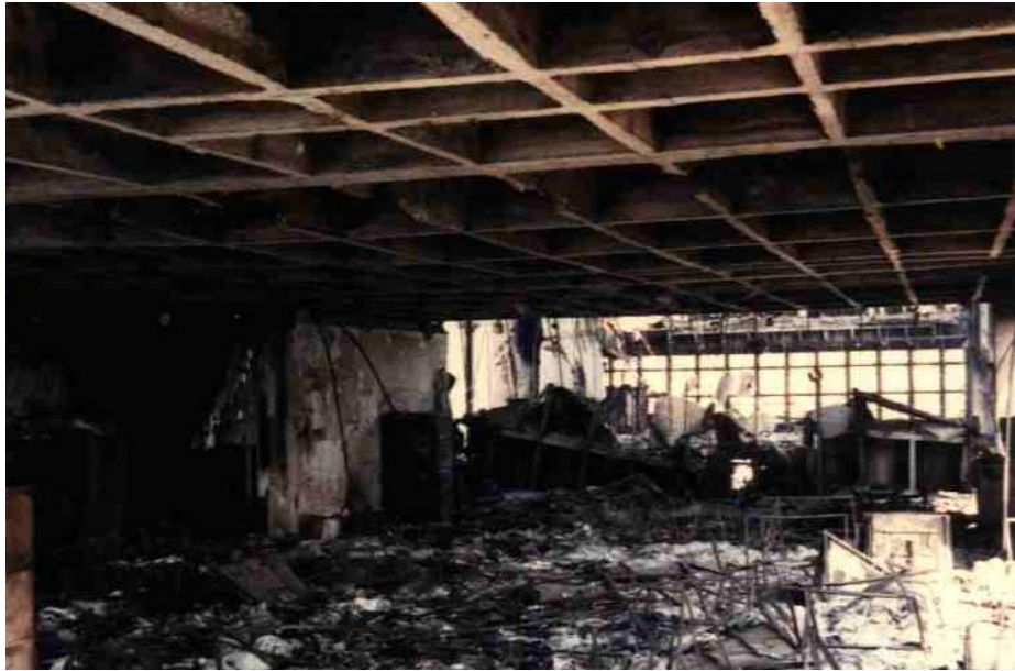
Figura 15. Vista da parte frontal da estrutura do edifício Sede II, a partir de sua parte posterior, com destaque para o vazio, deixado pelo desabamento da parte central
