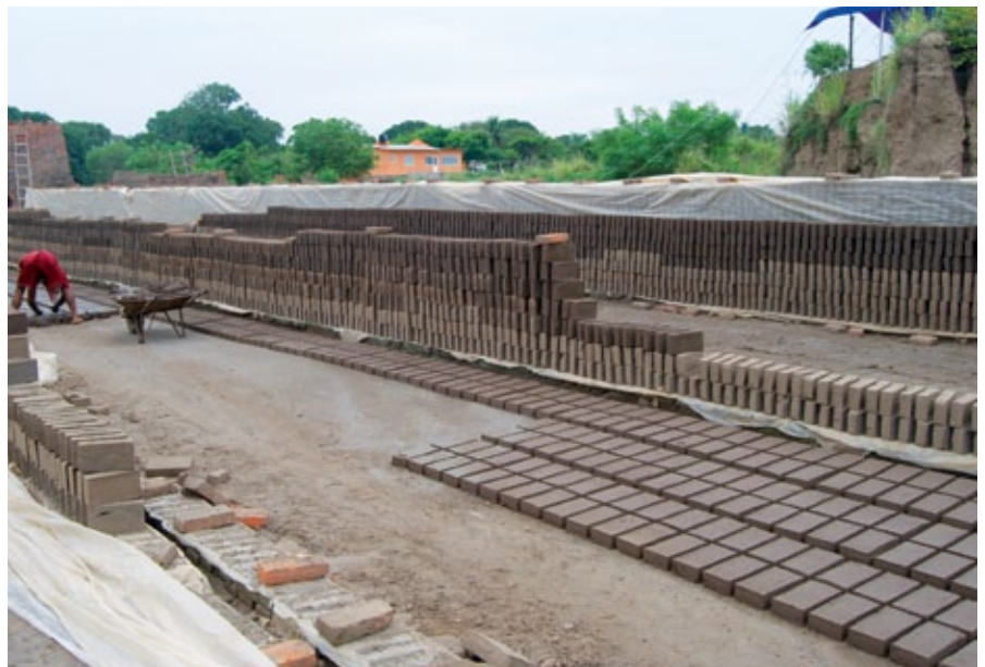
FIGURA 1. Fabricación de ladrillos con el material arqueológico. Al fondo a la derecha, vestigio arqueológico actualmente protegido mediante carpa (Fotografía: Luis Guerrero, 2008).
