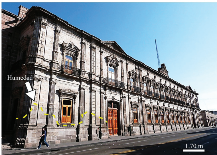
Figura 1. Localización de la ciudad de Morelia y fachada del Palacio Federal con evidencias del impacto de humedad por ascenso capilar (línea en amarillo; altura mayor de 2 m). Nomenclatura: Gd, Guadalajara, Gu, Guanajuato, Qe, Querétaro, Mo, Morelia, Me, Ciudad de México
