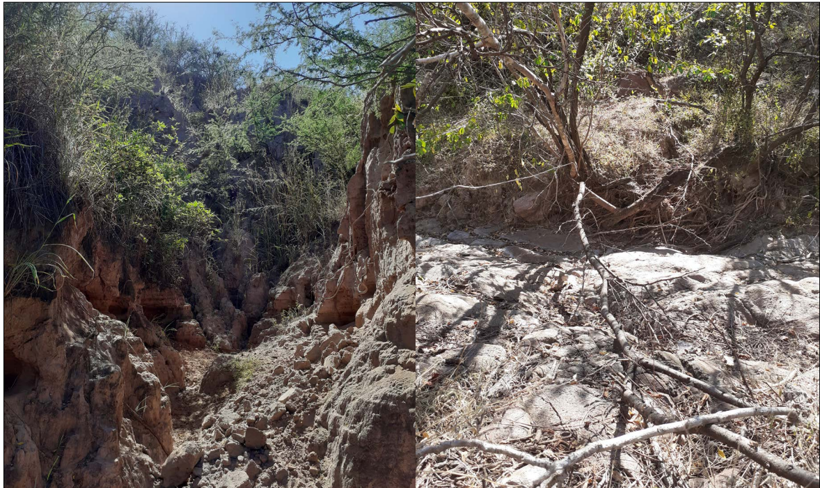
Figura 7. Evidencias de erosión de las presas de jales. a. Cárcavas inmensas; b. exhumación de raíces. Fotos: Roberto Márquez Huitzil, 2021.
