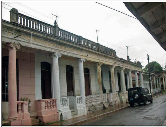
Figura 7. Viviendas construidas en el siglo XIX, de alta vulnerabilidad estructural, muy comunes en el centro de la ciudad de San Cristóbal.
