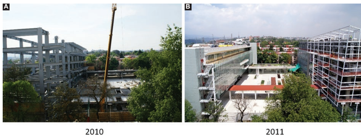
Figura 2. Construcción de las nuevas instalaciones del InDRE en Lomas de Plateros, Ciudad de México. A) Año 2010, foto de Rita Flores León. B) Año 2011, foto de Amelia Patiño González.
