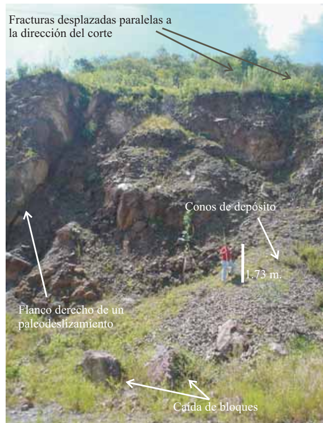
Figura 6. Vuelcos, desplomes y depósitos de caída acumulados en la parte baja de los cortes realizados por la obra civil. La discontinuidad corresponde al plano de movimiento de un paleodeslizamiento (Septiembre 2004).
