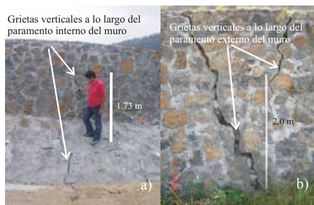
Figura 8a, 8b. Grietas verticales, generadas por el movimiento del muro de contención. La diferencia de tiempo en la captura de las fotos muestra el ensanchamiento progresivo de las grietas verticales. (Enero 2003, Septiembre 2004).
