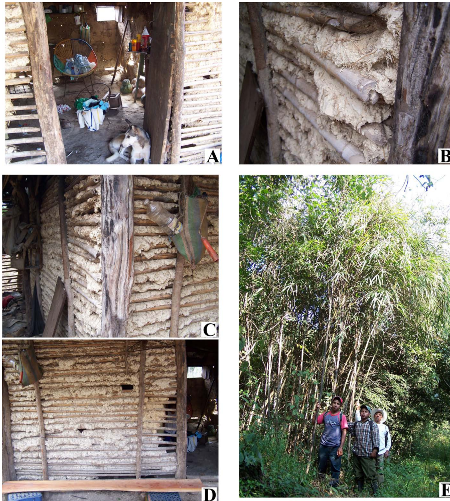
Figura 4. Casa habitación de bajareque construida con Oateea fimbriata en Roblada Grande, Villaflores, Chipas. A. Fachada donde se ven los culmos expuestos y el bajareque. B. Acercamiento de la esquina con detalle de los culmos de O. fimbriata . C. Esquina en vista panorámica. D. Muro lateral de bajareque. E. Culmos de O. fimbriata , en la foto Andrés, Herminio y Franco Robles. Fotografías de Eduardo Ruiz-Sanchez.
